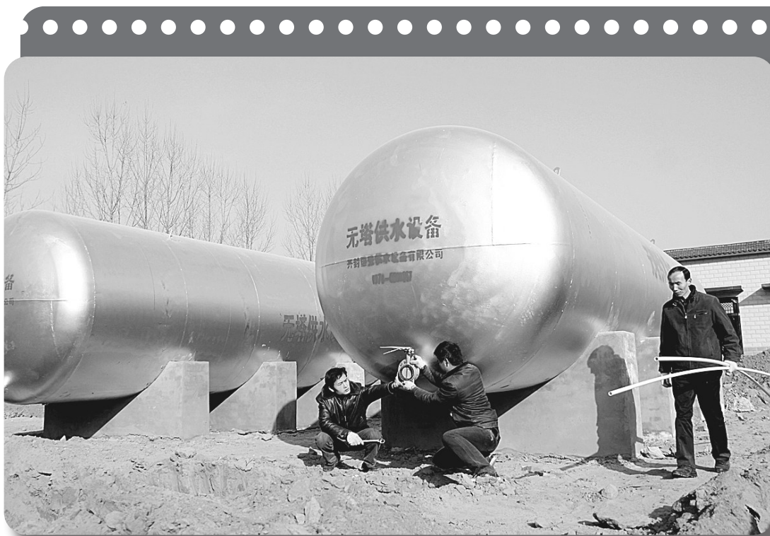
2010年,新郑市着力改善农村安全饮水工程管网建设,在全市建设万人集中水厂、联村供水工程、单村供水工程24处,解决了11万人的农村饮水安全问题。图为技术人员在八千水厂对无塔供水设备做最后安装调试。
