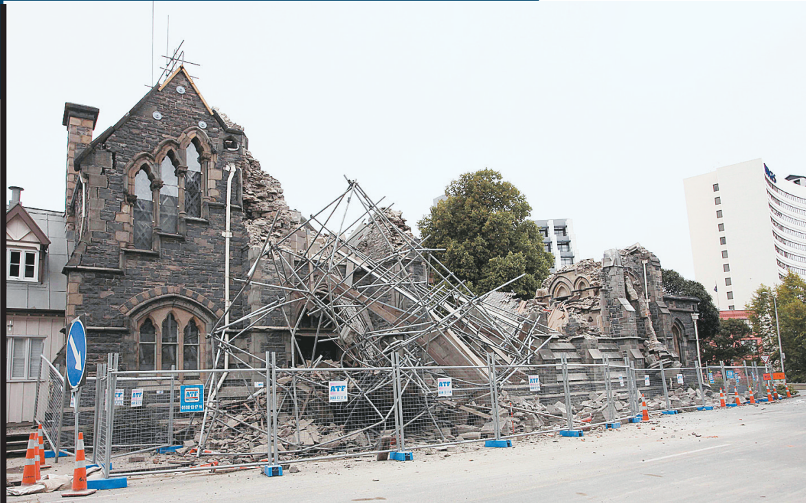
图为在地震中受损的建筑物。 新华社发
