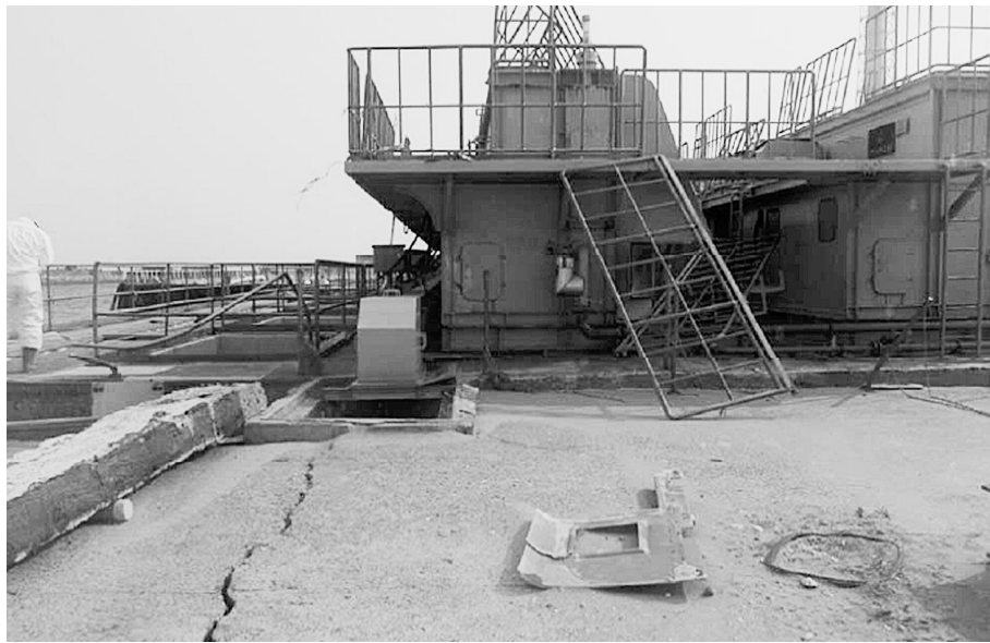
这张日本原子能安全保安院4月3日提供的照片显示,4月2日,一条裂缝延伸至福岛第一核电站2号机组取水口附近的电缆竖井旁。 新华社发
