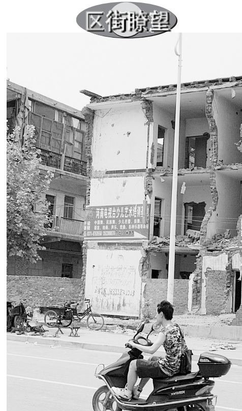
市民张先生向本报反映,中原区冉屯路晶华城小区售楼部西侧,两栋拆了一半的危房不仅给过往市民带来很大的安全隐患,也严重影响市容市貌。附近居民告诉记者,该楼原是郑州车辆厂家属楼,拆除一小部分后,两年内一直没人管,希望有关部门能够及早消除隐患。
