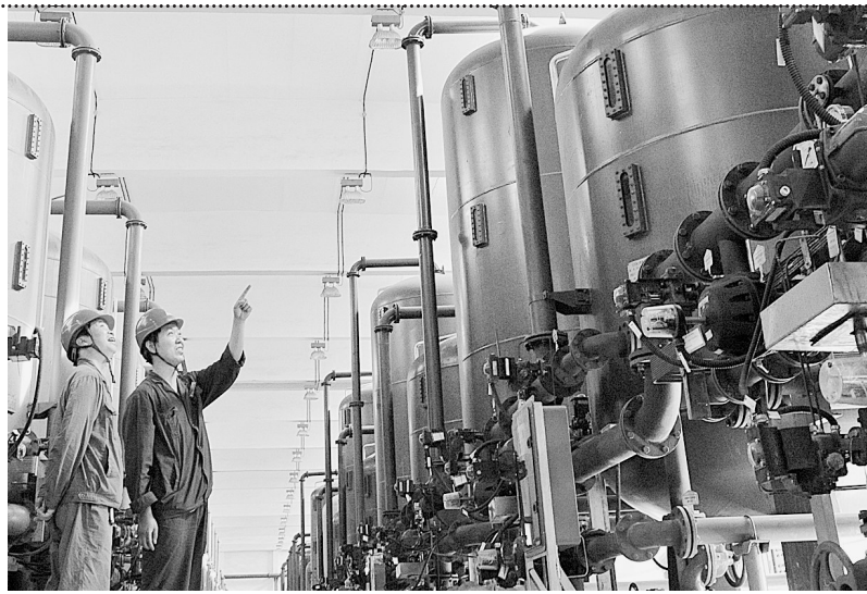
豫联集团投资4000多万元组建的污水处理系统。本报记者 许大桥 摄
