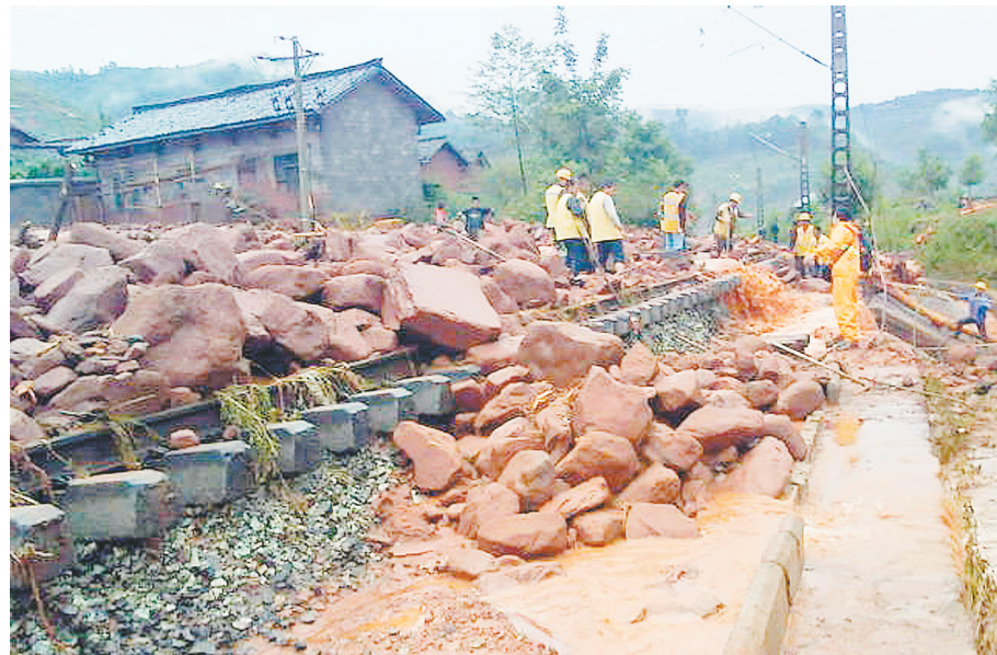
6月17日,救援人员在中断的铁路上进行排险作业。新华社发
