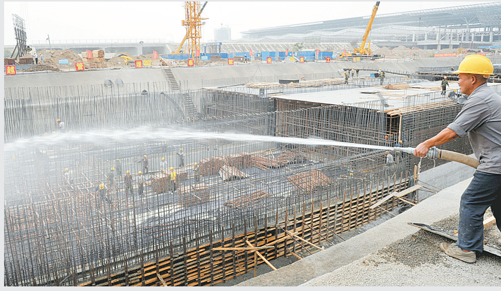
昨日,在郑东新区107辅道道路及下穿隧道工程施工现场,市政工程总公司的施工人员正在紧张作业。据了解,该工程有望在11月30日建成,与石武客专郑州东站同时投入使用。 本报记者 丁友明 实习生 李左林 摄
