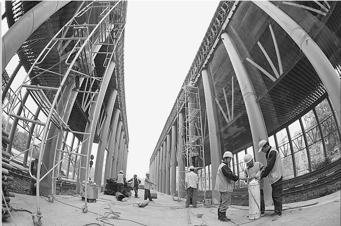
由中铁七局郑州工程有限公司承建的“畅通郑州”工程重点项目京沙快速通道马寨大桥上跨铁路的三座承重防护棚即将全部完工。昨日下午,施工人员在马寨大桥承重防护棚侧面安装防护网,以保证施工期间过往车辆通行安全。
