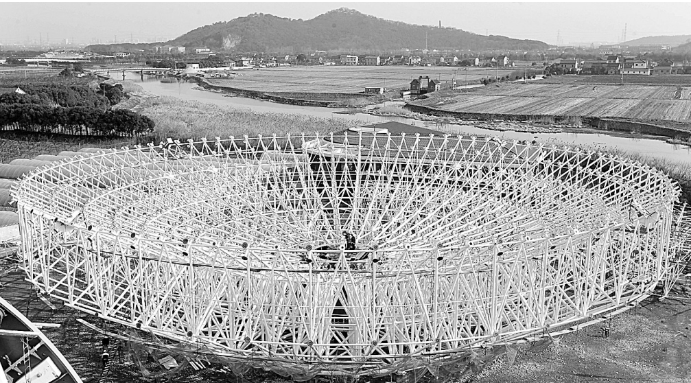
目前,65米口径可转动射电天文望远镜工程在上海佘山脚下紧张施工,这将是亚洲最大的该类射电望远镜,总体性能在国际上处于第四位。据介绍,这台望远镜属于中国科学院和上海市政府重大合作项目,预计于2012年下半年建成。 图为正在建设中的上海65米口径可转动射电天文望远镜。 新华社发
