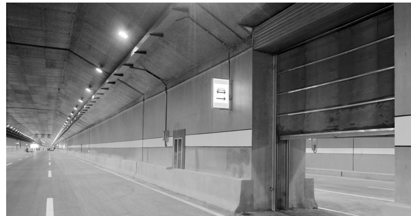
隧道内设立的应急安全门。
