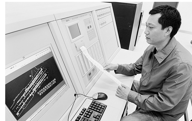
先进的控制系统，对隧道内的通风、消防、温度等设施实现全自动监控。
