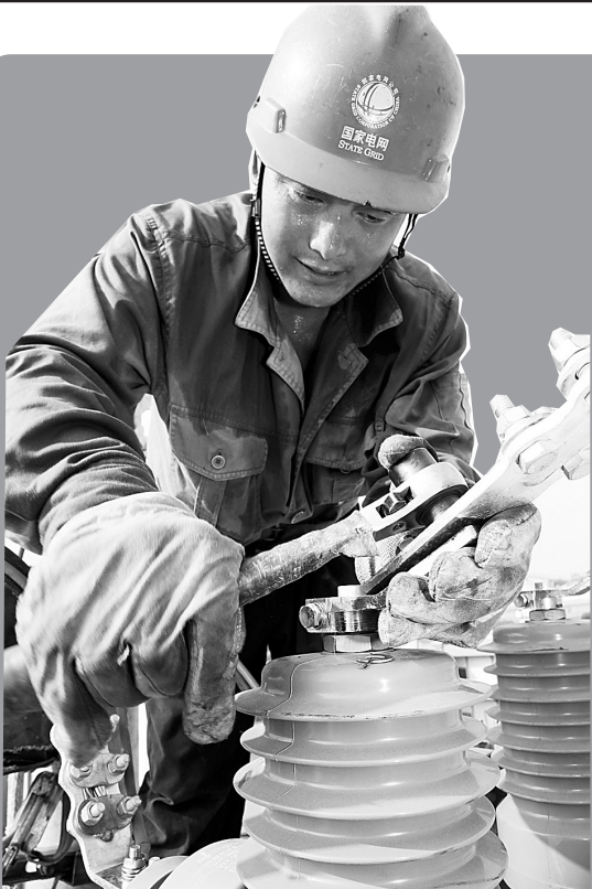
酷暑下的电力“抢修哥”李洋在中牟县绿云小区安装变压器线夹。
