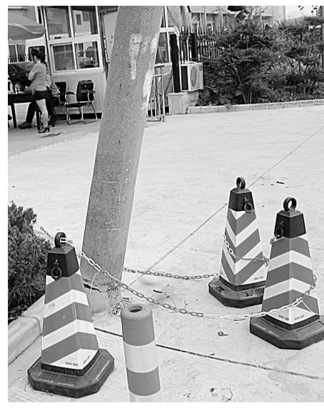
昨日,记者在金水路与未来路交叉口北100米金水河畔看到,汇金商务酒店门口电线杆断裂,据称已经有四五天了,希望有关部门尽快处理,别砸伤了路人。 本报记者 李瑞蕊 摄
