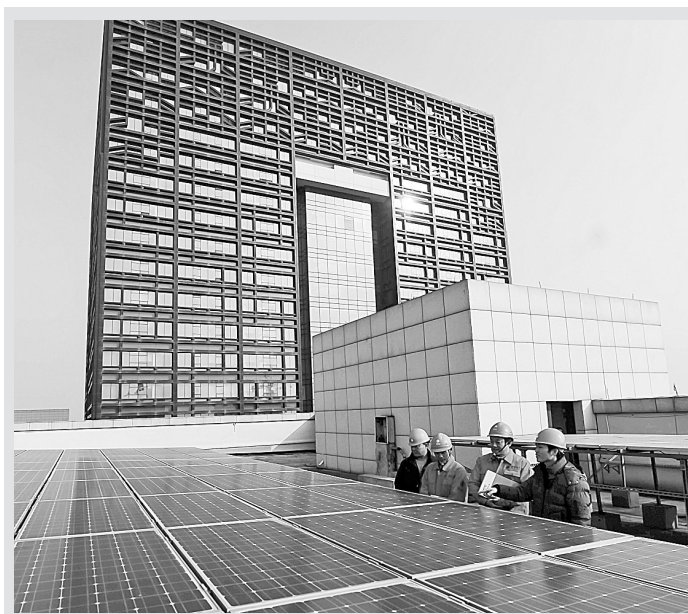
12月24日,在湖州电力局和南浔区政府共同努力下,浙江省湖州市首个市本级分布式太阳能屋顶发电项目正式并网发电。该发电项目位于湖州市南浔区政府大楼顶部,总面积超过5000平方米,安装光伏发电板1646块,预计全年发电量为32万度(千瓦时)。按照该项目25年发电800万度计算,可比传统火力发电减少排放8000多吨二氧化碳,节省3000吨煤炭,具有良好的环保示范作用。图为工作人员在巡检刚刚并网发电的太阳能光伏电板。 新华社发
