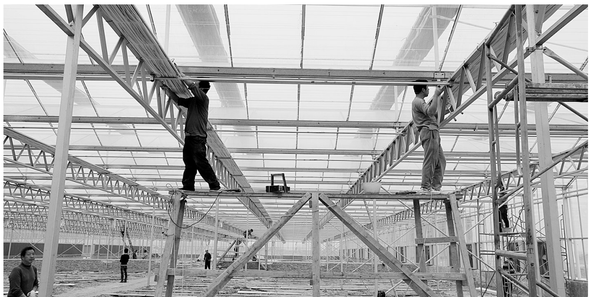
智能连栋温室的主体结构已基本完工,工人们正在安装电子设备。
