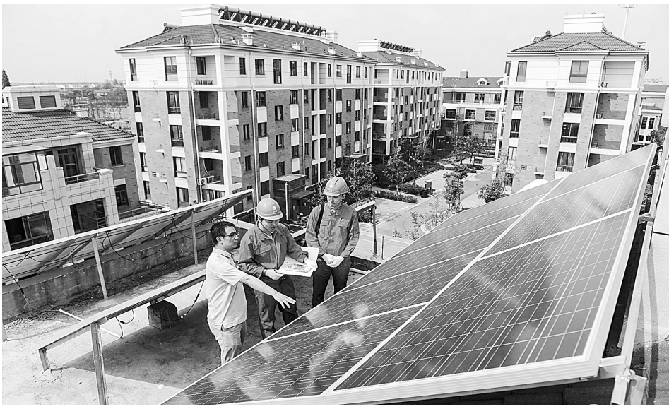
9月3日,长兴县居民王晚刚(左一)在自己家的楼顶上与电力部门工作人员查看并网的分布式光伏发电装置。他刚刚安装完毕进入并网试运行的屋顶光伏设施花了3万多元,由16块光伏板组成,光照充足的情况下每天能发电15~20千瓦时。 8月30日,国家发改委发布通知,确定了光伏地面分布式光伏发电补贴政策。对于屋顶分布式光伏发电电价,实行全电量补贴政策,补贴价格0.42元/千瓦时,通过可再生能源发展基金支付。这意味着光伏项目的投资回报得到明确,将会带动国内光伏装机容量提升。 新华社发
