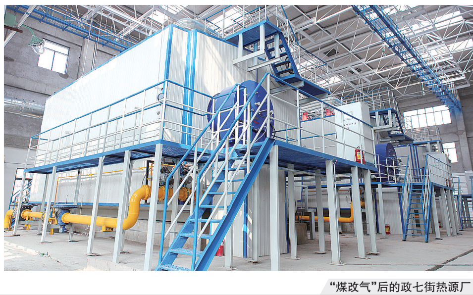
“煤改气”后的政七街热源厂
