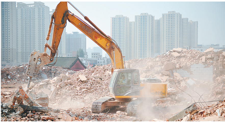
二七区孙八寨拆迁工地现场,未采取洒水喷淋等降尘措施。
