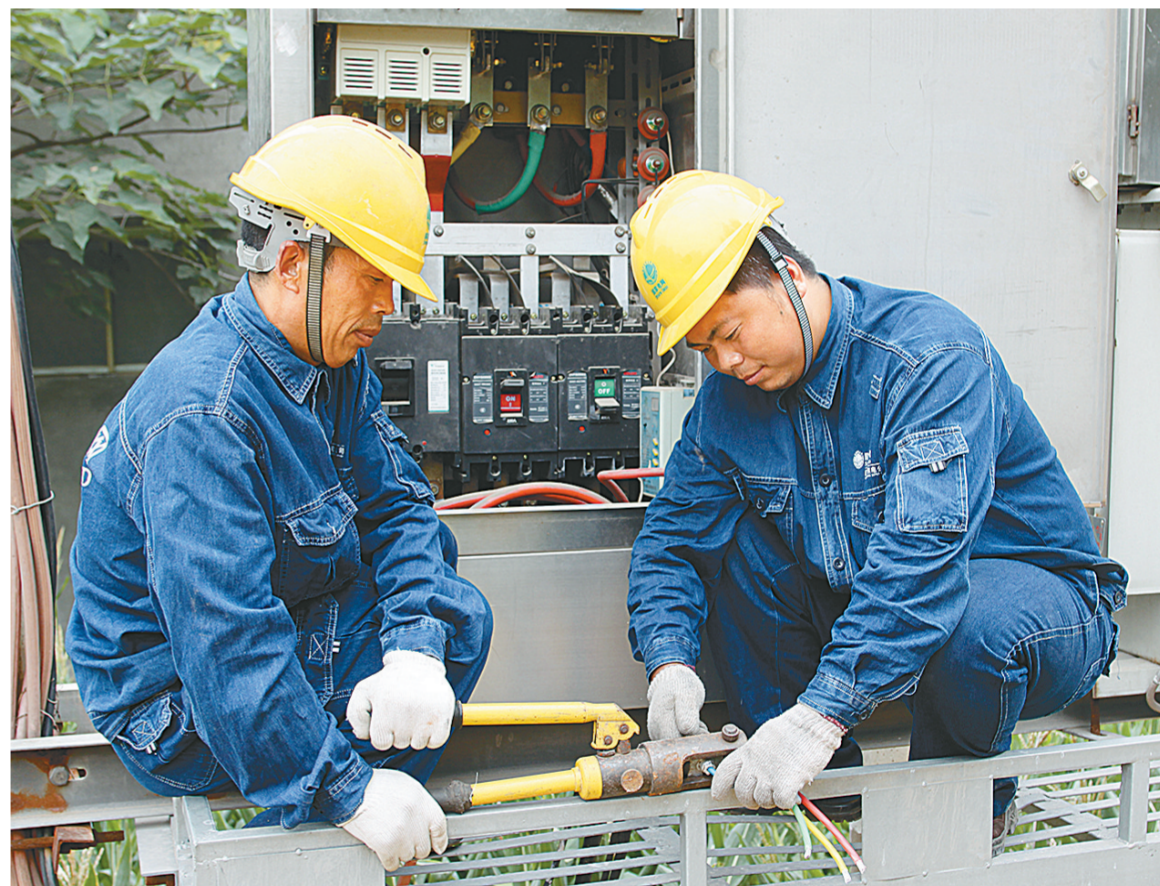
新郑市供电公司成立“三秋”服务队，随时解决群众用电难题，并在此基础上开辟便民服务绿色通道，对涉及“三秋”生产的用电报装、维修等简化程序，提供24小时报修服务，全力提高秋收安全用电水平。
