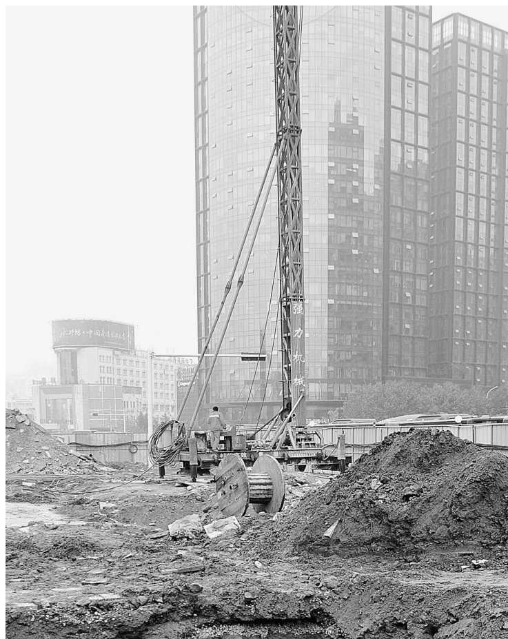
未来路与金水路交叉口西南角下穿隧道工地，因为地下埋有热力管道，导致钻机停工。
