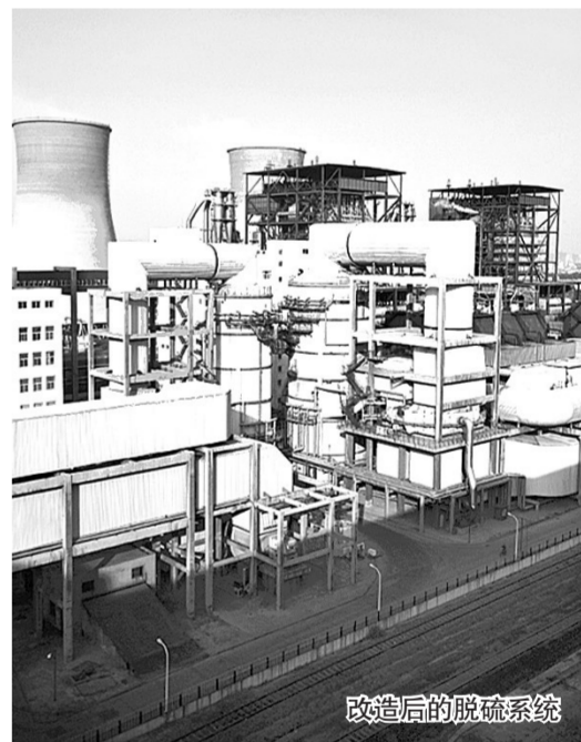
改造后的脱硫系统
