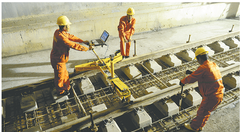
昨日,郑州至机场(新郑机场)城际铁路地下车站工程全面完成无砟轨道施工,标志着该工程将进入全线铺轨阶段。 新华社发
