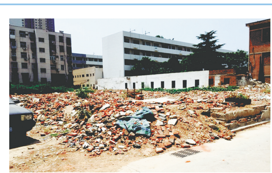
工人路37号院工地垃圾遍地
