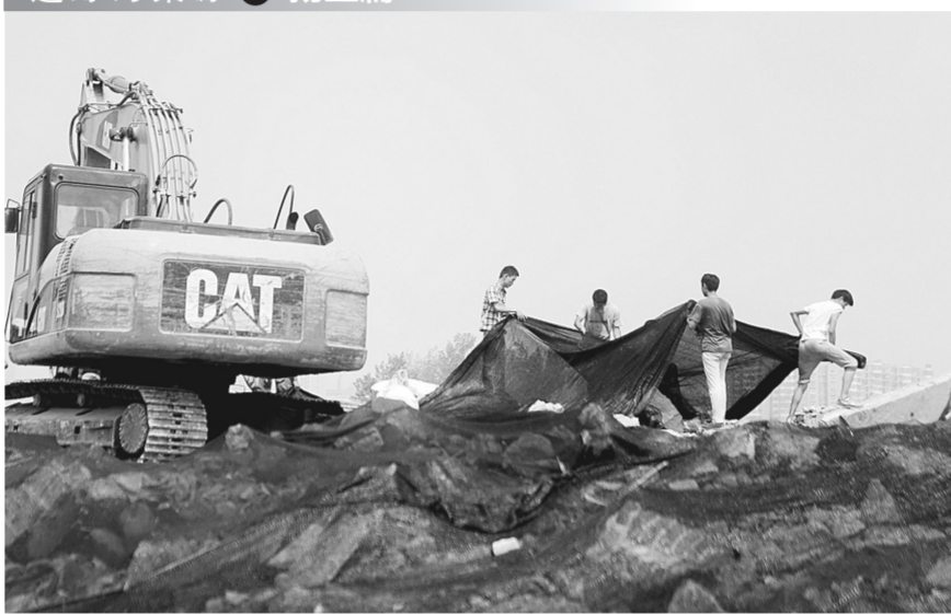
紫荆山南路办事处对南十里堡城中村改造项目工地进行防尘覆盖。 本报记者 栾月琳 摄
