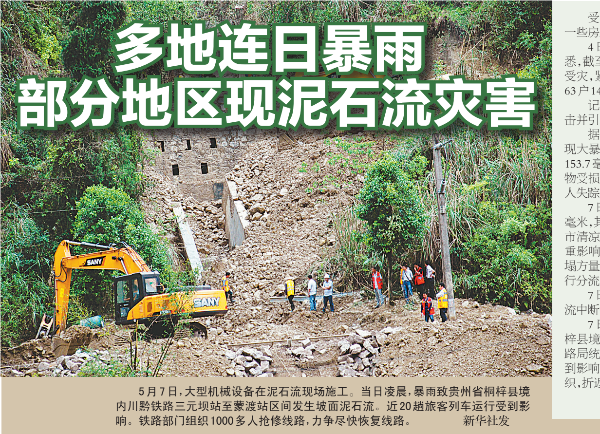
5月7日，大型机械设备在泥石流现场施工。当日凌晨，暴雨致贵州省桐梓县境内川黔铁路三元坝站至蒙渡站区间发生坡面泥石流。近20趟旅客列车运行受到影响。铁路部门组织1000多人抢修线路，力争尽快恢复线路。 新华社发
