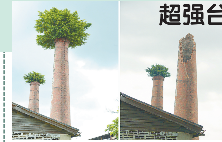
左图,下炉村原“地方国营惠安糖厂”两根红砖烟囱上长出茂盛的榕树(8月3日摄);右图,一棵阔叶树被台风吹落(9月14日摄)。
