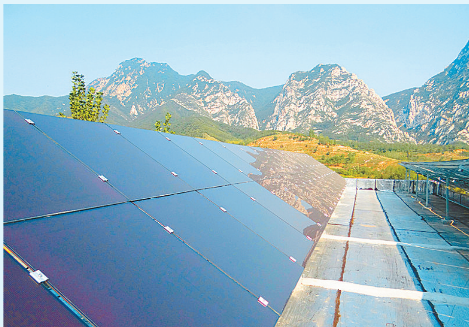
光伏发电项目
