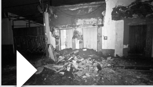
9月8日，在墨西哥瓦哈卡，地震导致一处墙体坍塌。新华社发
