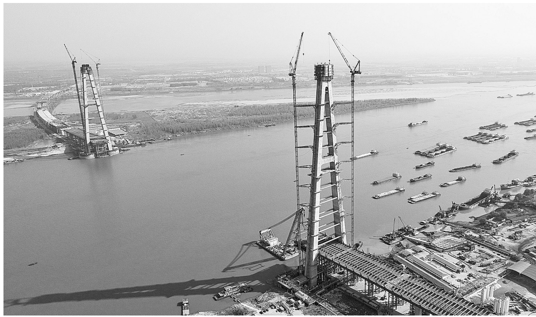
4月10日,武汉青山长江大桥南岸主塔成功封顶。当日,正在建设中的武汉第11座长江大桥——青山长江大桥南岸主塔封顶。此次封顶的南岸主塔高271.5米,相当于约100层楼房的高度,是目前已建在建的世界最高A型桥塔。新华社记者 肖艺九 摄
