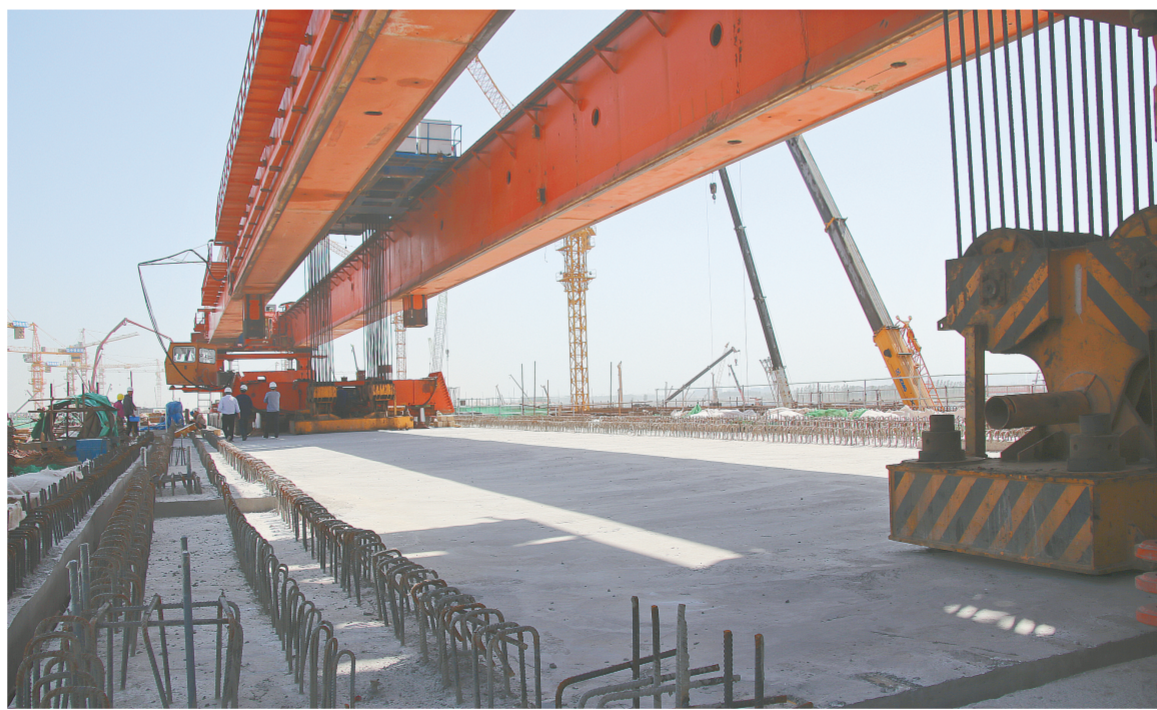
昨日,郑州南站郑万正线预制箱梁架设全部完成,标志着郑万铁路河南段梁架实现贯通,为郑州南站郑万正线铺轨和8月1日联调联试奠定了基础。 本报记者 成燕 摄
