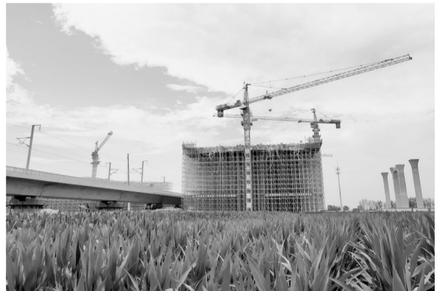
经过35小时施工,由中铁二十五局二公司承建的郑州航空港区迎宾大道上跨郑万高铁转体桥工程首个箱梁0#块于昨日9:25顺利浇筑完成,标志着迎宾大道上跨郑万高铁转体桥进入了施工最后冲刺阶段。 本报记者 张倩摄
