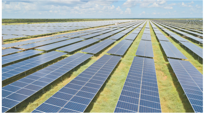
这是12月13日拍摄的肯尼亚加里萨50兆瓦光伏电站太阳能电池板 新华社记者 谢哈 摄
