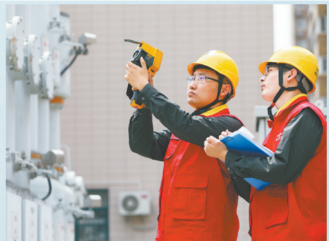
排查变电站设备隐患
