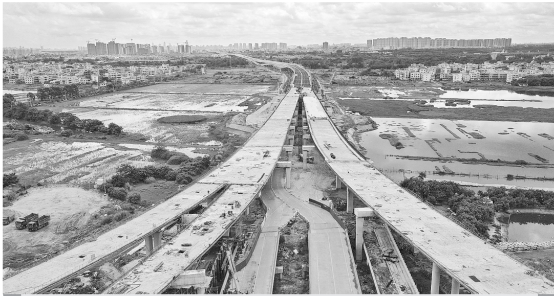
9月2日拍摄的沈海高速海口段项目施工工地(无人机照片)。G15沈海高速公路海口段是G15沈海高速和G75兰海高速在海南的“最后一公里”,也是海南省高速公路连接全国高速公路网的唯一通道,路线全长13.727公里。目前,G15沈海高速公路海口段项目主体工程已完成60%,计划在2022年底建成通车。新华社记者 郭程 摄
