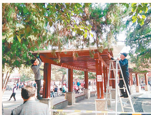
为扎实开展“我为群众办实事”实践活动，河南省工人文化宫聚焦人民群众“急难愁盼”问题，对五一公园的基础设施进行完善提升。针对园区缺少避雨场所、照明设施缺失、部分座椅损坏问题，在园内3个长廊加装了阳光板，为市民增加临时避雨场所；在园区增设投光灯20盏，调整现有射灯的照射角度与性能，既保障游客夜间游园安全，也避免过度照明。同时，工作人员自己动手，对园区内160个座椅进行保养修理，加装井盖防坠网20个，营造舒适宜人的游园环境。图为工作人员正在加装阳光板。本报记者 裴其娟 通讯员 窦可 摄影报道
