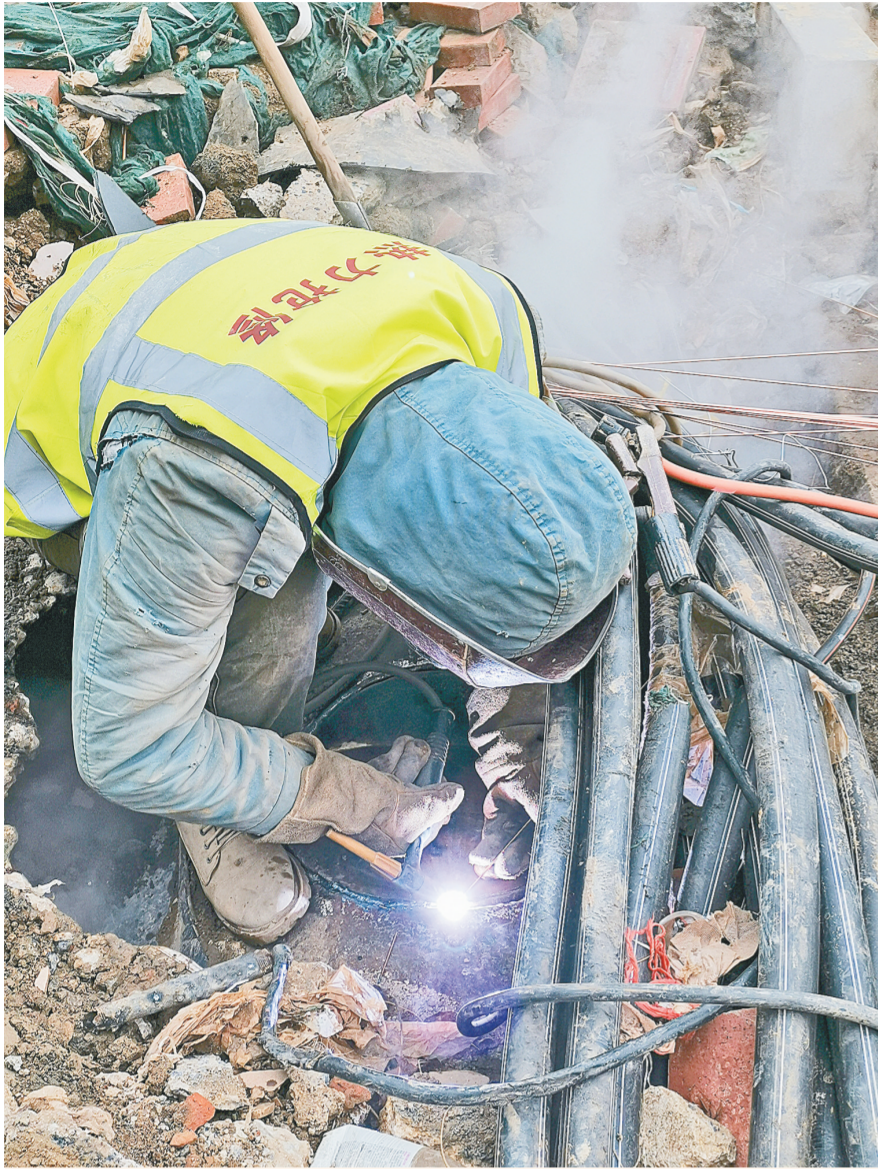
郑州热力集团有限公司把为群众提供优质供热服务作为出发点和落脚点，积极落实“我为群众办实事”实践活动，不断提升供热服务能力和水平，持续加强设施检修维护力度，真正做到心系百姓冷暖。图为昨日东风路与文博西路西南角供热管网突发故障，工作人员全力抢修故障管网。 郑报全媒体记者 张华 摄
