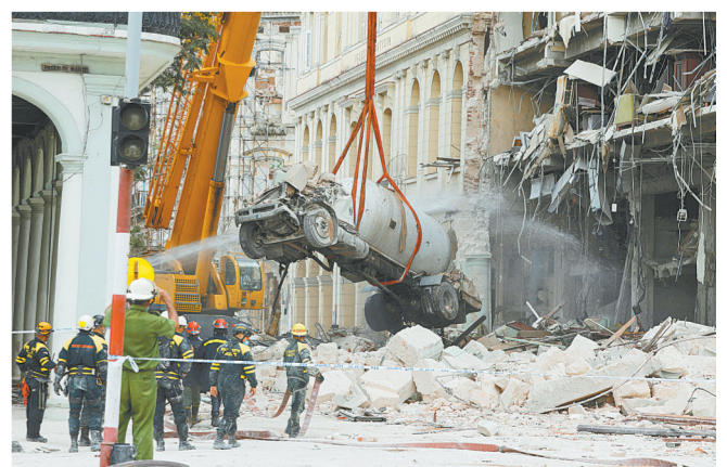
5月6日，在古巴首都哈瓦那的萨拉托加酒店爆炸事故现场，一辆液化气罐车被从废墟中吊起。萨拉托加酒店6日上午受到剧烈爆炸冲击，死亡和受伤人数已分别上升至22人和74人。初步调查显示，爆炸或为酒店外一辆液化气罐车发生泄漏所致。新华社发
