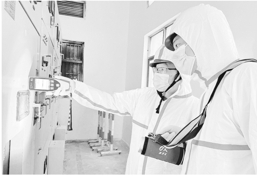
工作人员检查电力设备运行状态
