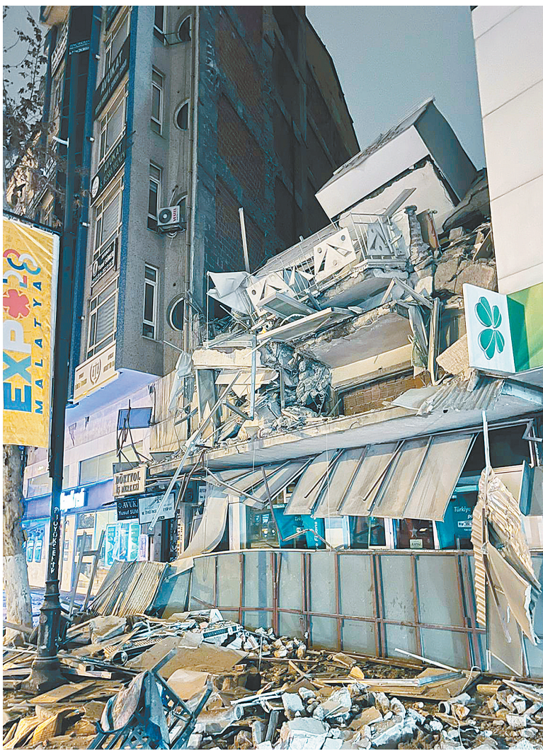
这是2月6日在土耳其马拉蒂亚拍摄的一处倒塌的建筑。 新华社发
