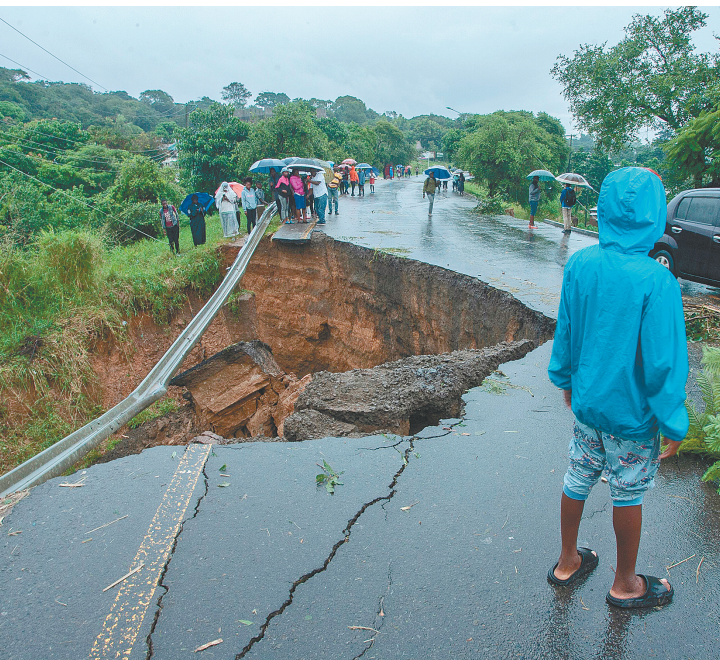
这是3月13日在马拉维布兰太尔拍摄的一处被洪水冲毁的道路。
