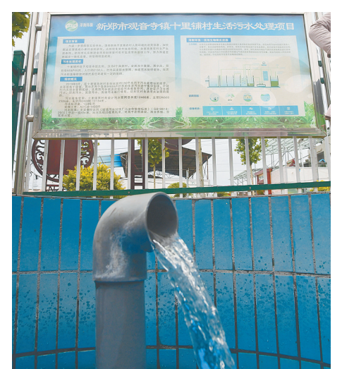
新郑市观音寺镇十里铺村小型污水处理站内,处理后的污水变成清水流出
