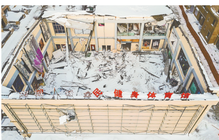
这是11月7日拍摄的发生屋顶坍塌事故的黑龙江省桦南县悦城体育俱乐部(无人机照片) 新华社记者 陈益宸 摄
