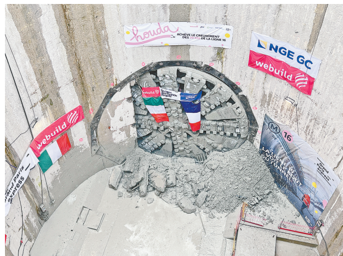
中铁装备研制的“中铁777号”盾构机目前已完成巴黎地铁全部掘进任务(受访者供图)
