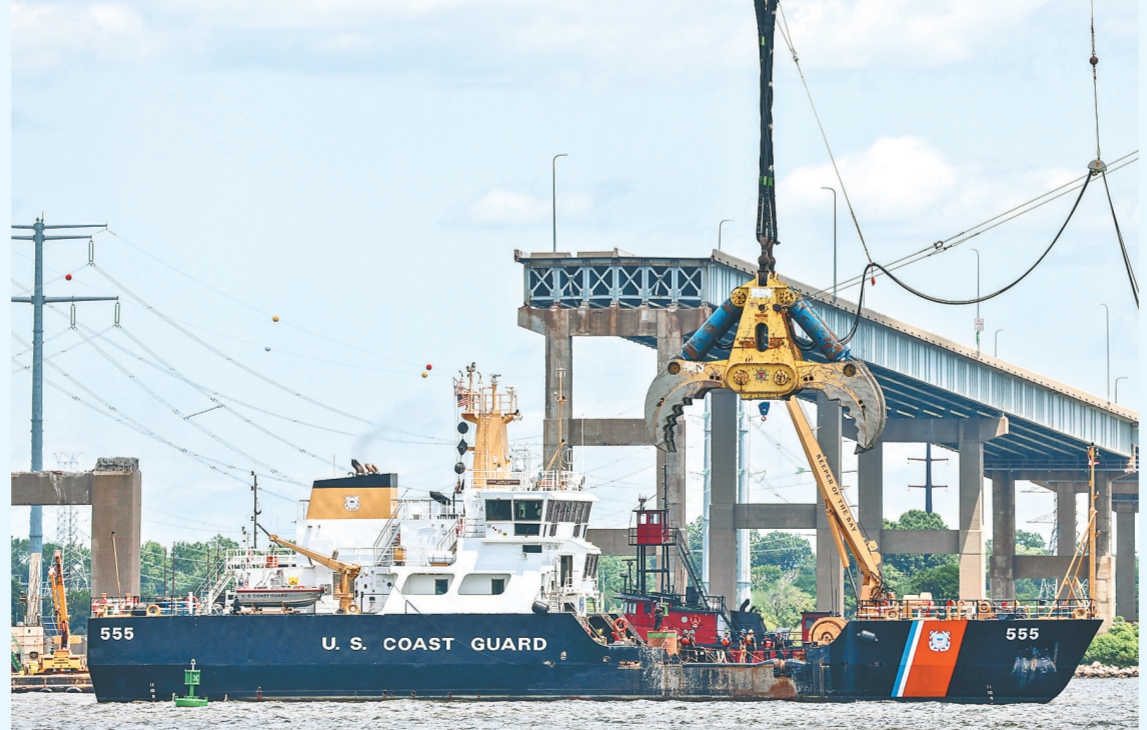
6月10日,在美国马里兰州巴尔的摩港,海岸警卫队船只经过“弗朗西斯·斯科特·基”大桥附近的撞桥事故残骸清理工作现场。
