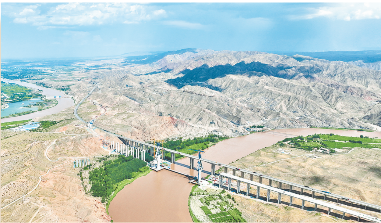
6月26日拍摄的沙坡头黄河公路大桥施工现场(无人机照片)。宁夏中卫市沙坡头黄河公路大桥全长1539米，为双塔双索面半漂浮体系钢混组合梁斜拉桥，塔高145米，双向4车道，设计时速80公里，是国道338线中卫至孟家湾段项目的重要控制性工程。新华社发(袁宏彦 摄)
