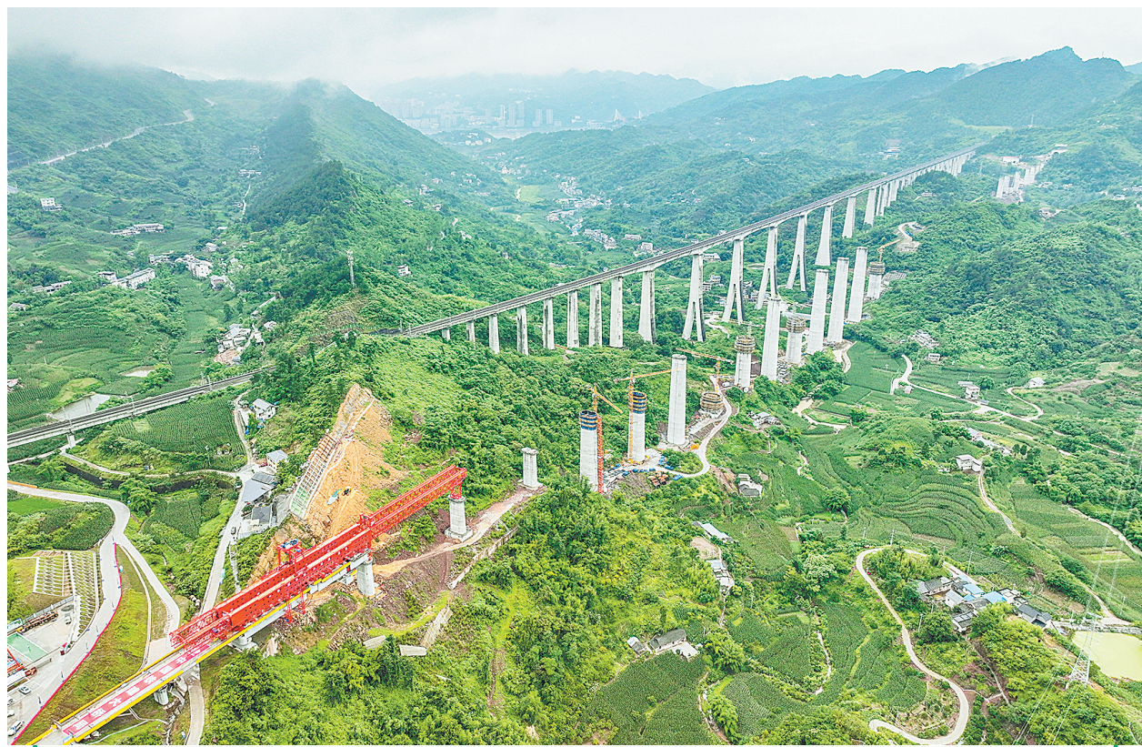
6月26日，渝万高铁新桥双线特大桥建设现场，架桥机在架设首孔64m节段拼装梁（无人机照片）。当日，由中铁二院设计、中国铁建大桥工程局承建的渝万高铁新桥双线特大桥64m节段拼装梁首孔架梁完成。作为渝万高铁全线唯一一个采用节段拼装工艺施工的桥梁，首孔梁的成功
