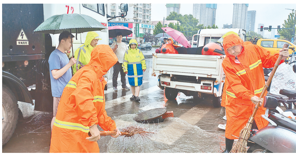
昨日,二七区启动防汛排涝应急预案,全力进行抢险排涝工作。
