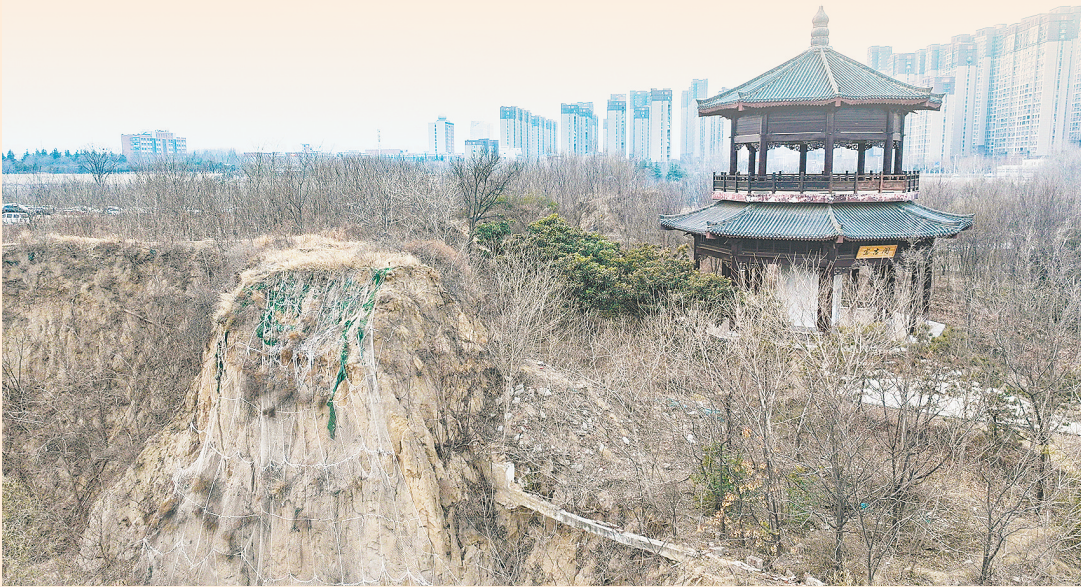
保吉寨东北角的寨墙围着防护网以防坍塌
