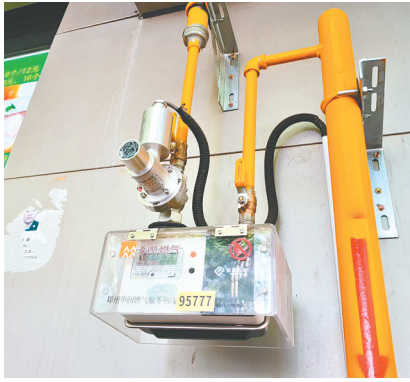
燃气表具+燃气报警切断装置
