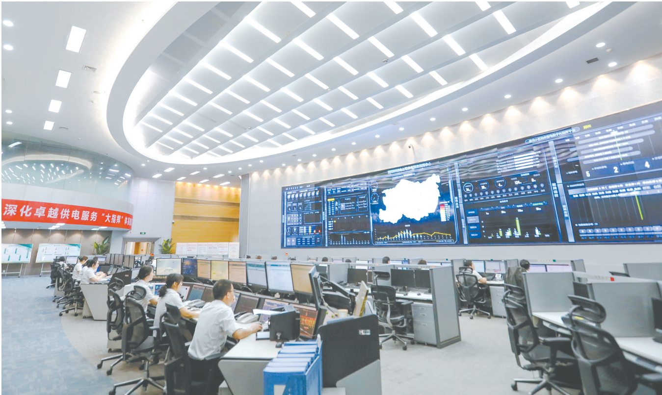
工作人员通过供电服务指挥系统远程监控自愈系统运行情况
